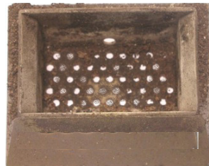
Cuve de combustion nécessitant un nettoyage avec les trous obstrués par des cendres
